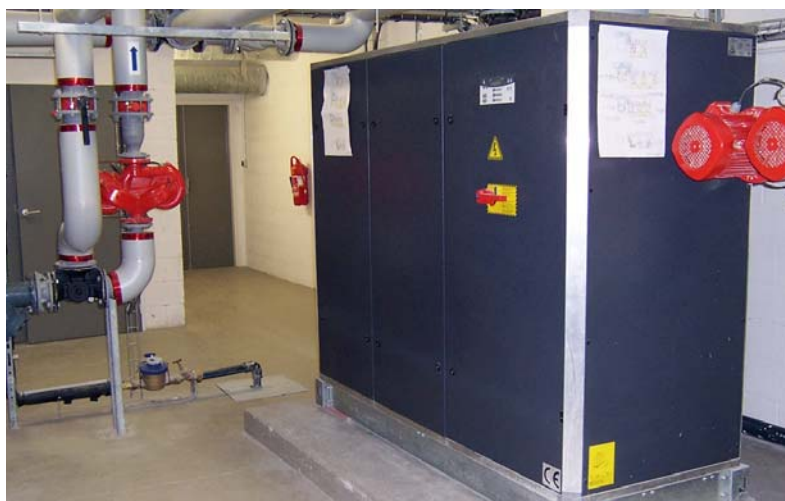
La pompe à chaleur.
