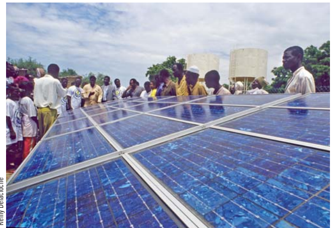
Regroupées sous la forme de modules, les cellules photovoltaïques produisent un courant électrique proportionnel à l'ensoleillement.
