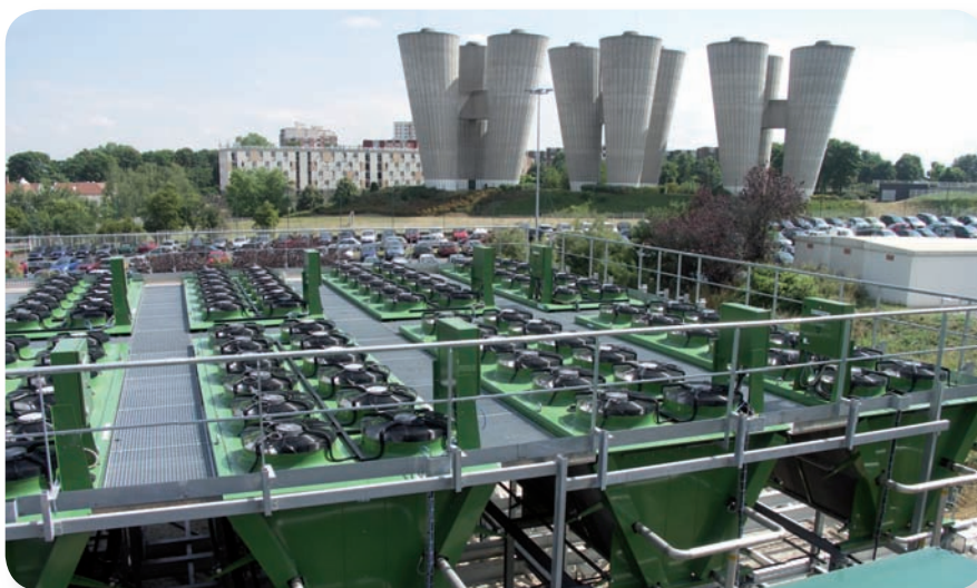
Les aérocondensateurs à l'IGR
