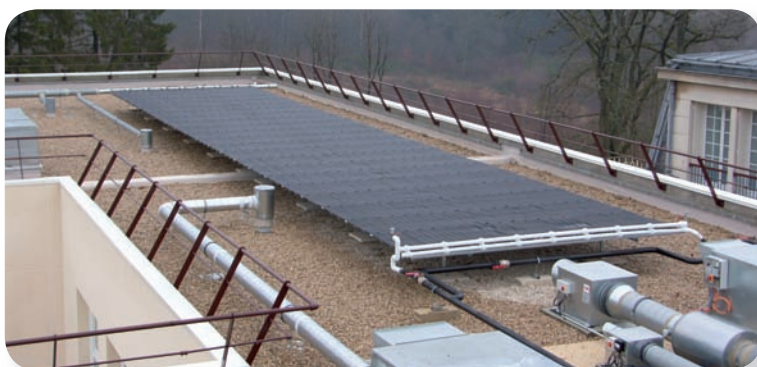
Vue sur le capteur solaire
