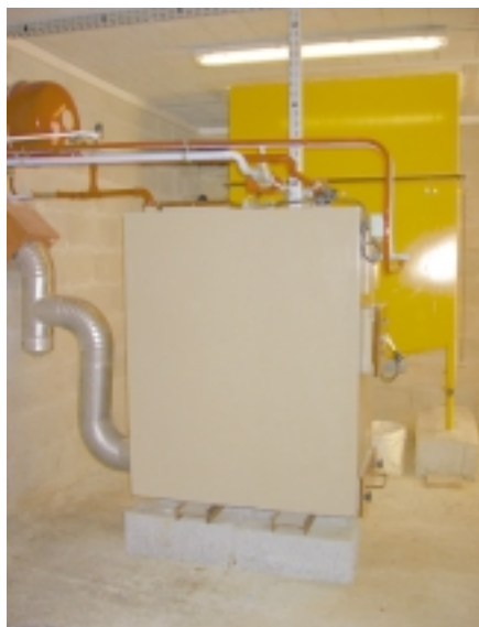
La chaudière et la trémie d'alimentation automatique au second plan.
