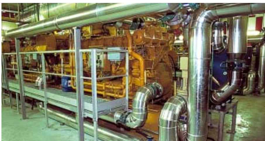
Centrale de cogénération, place Alfred de Musset.
