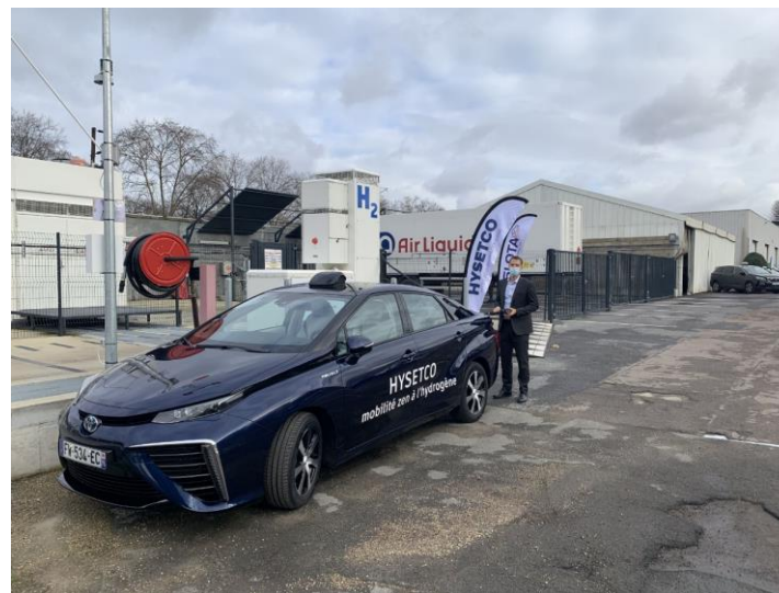
Station hydrogène Hysetco sur le dépôt taxi de Slota à Porte de la Chapelle © Hysetco
