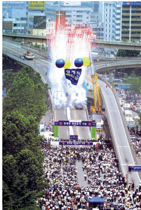
Cérémonie d'inauguration de la démolition du viaduc 1 er juillet 2003 © Seoul Metropolitan Government
